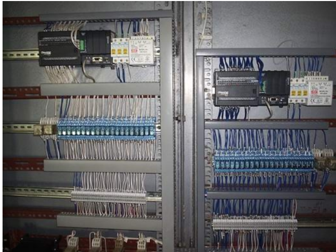
Станция управления подпиткой
