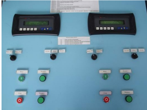
Панель управления станцией
