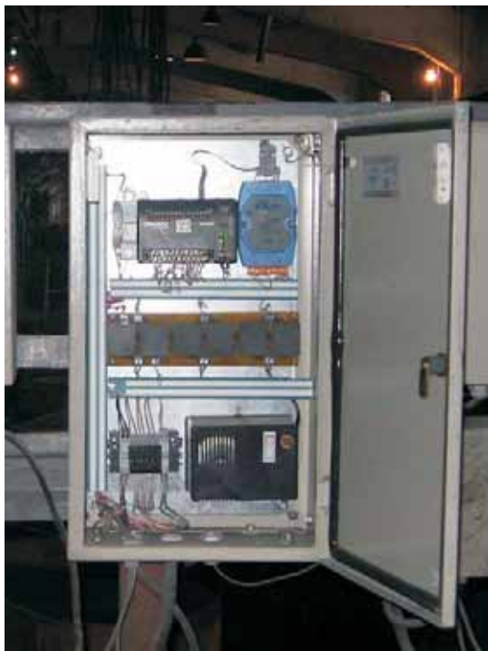
Шкаф управления системы
