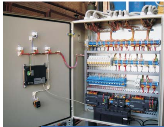
Щит управления котлами
