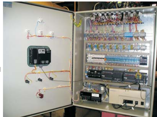
Щит управления котла
